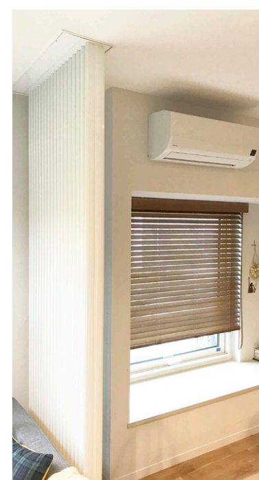
室内の空調設備は、エアコン型と放射パネルタイプがある
